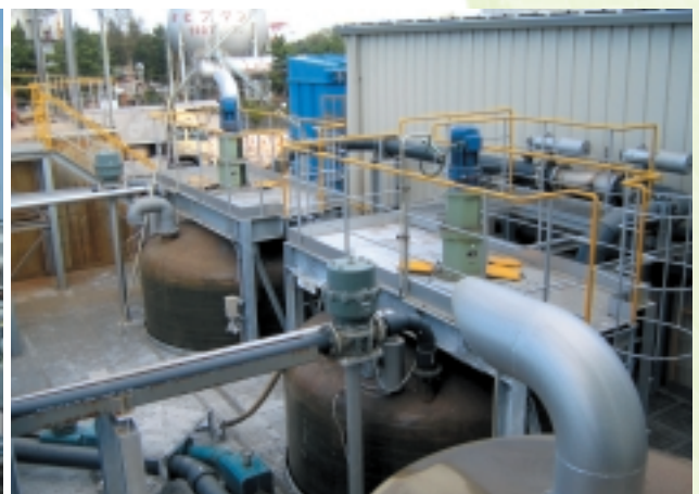
(株)MTR 脱塩処理設備
